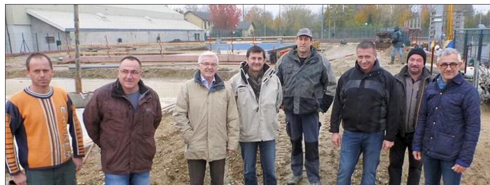
Les responsables ont pu se rendre compte sur place de la bonne avancée du chantier.
