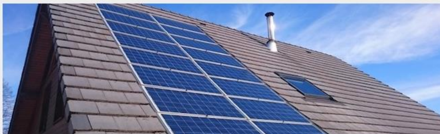
— Une vingtaine d'installations photovoltaïques sont prévues par la société Grési 21. DR
