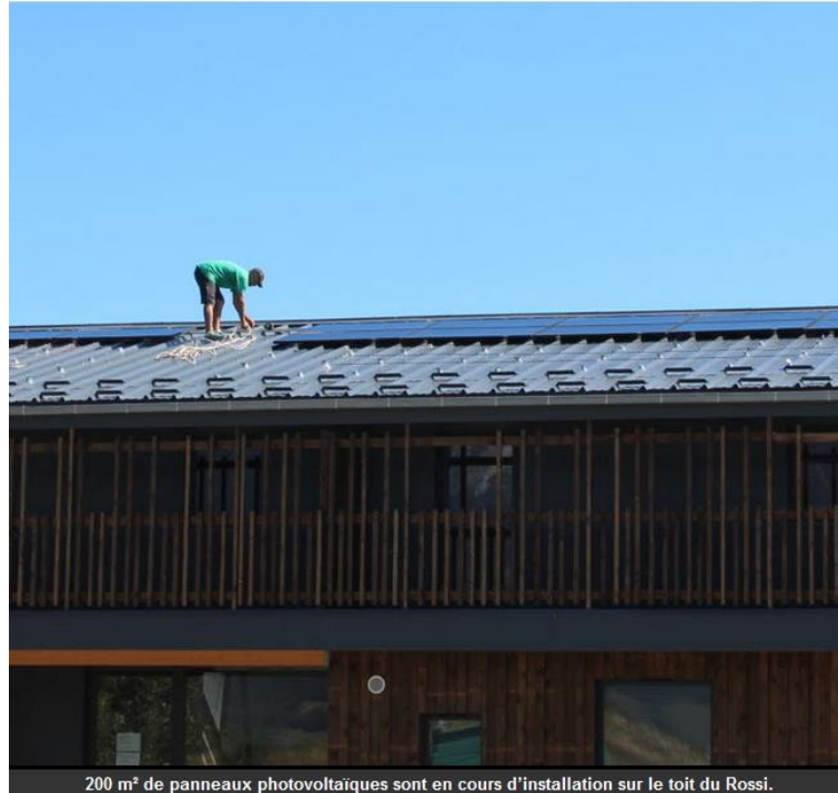
200 m 2 de panneaux photovoltaïques sont en cours d'installation sur le toit du Rossi.
