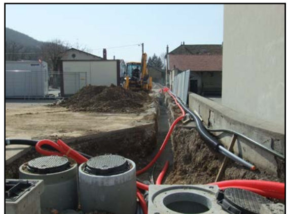
Réseau de chaleur
